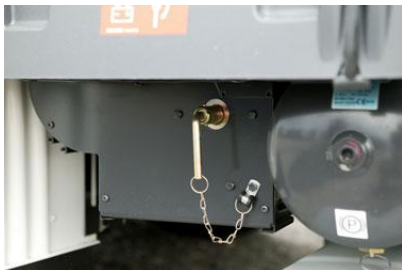
Выключатель "массы" аккумуляторной батареи, техобслуживание.
